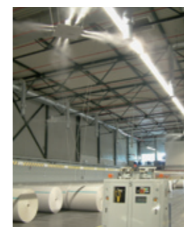
Tagesrollenlager mit Hochdruckbefeuchtung TurboFog 32
