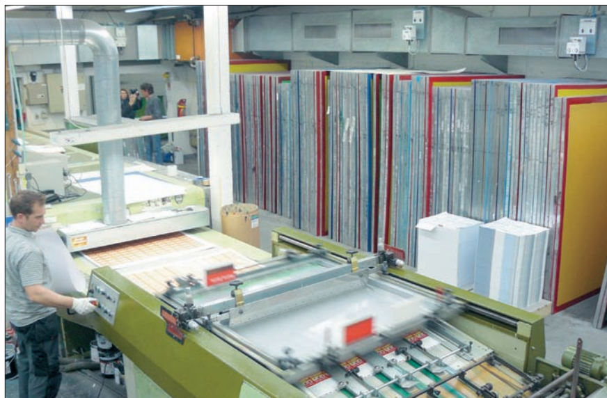
In einem Druckraum bei „von Z“: Über den Siebrahmen an der Wand sind zwei der Vernebler der Befeuchtungsanlage installiert. Bei Hochdruck-Wetterlagen sind sie im Dauereinsatz.
