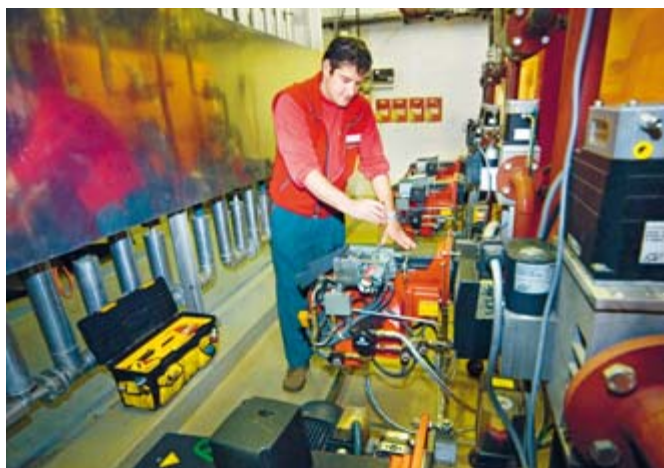
Feuerungstechniker Christian Menzi reguliert einen der vier Oertli Brenner im Alpamare.
